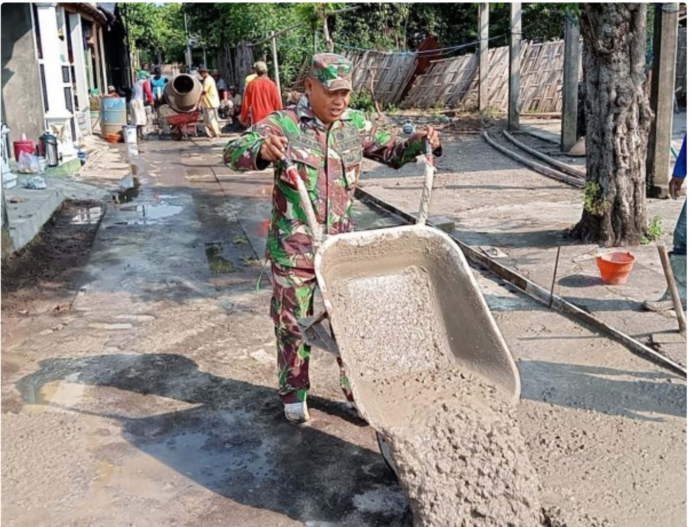
Babinsa Desa Wadunggetas Bersama Warga Gotong Royong Dalam Karya Bakti Betonisasi Jalan
